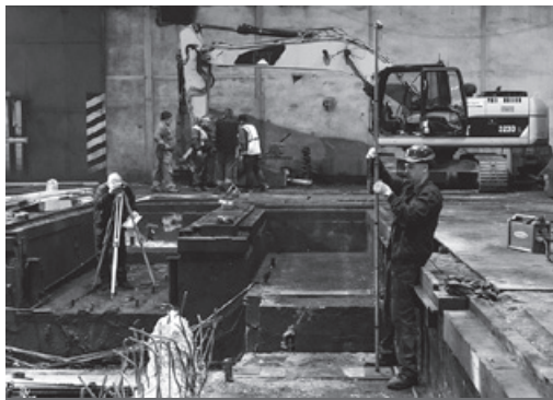
Již od začátku prosince probíhají práce na částečné generální opravě s částečnou modernizací kovacího souboru s lisem CKV 1800/2250 v provozu kovárny na hale 9. Zmodernizované zařízení bude uvedeno do zkušebního provozu koncem ledna.
