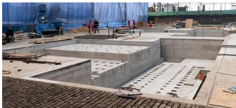
Na hale 5 probíhají v 8. poli v těchto dnech dokončovací práce na základových konstrukcích pro tři horizontky pro Divizi Strojírny. Horizontky v současné době prochází modernizací. Stavební práce budou dokončeny letos v únoru, následovat bude montáž modernizovaných strojů.
